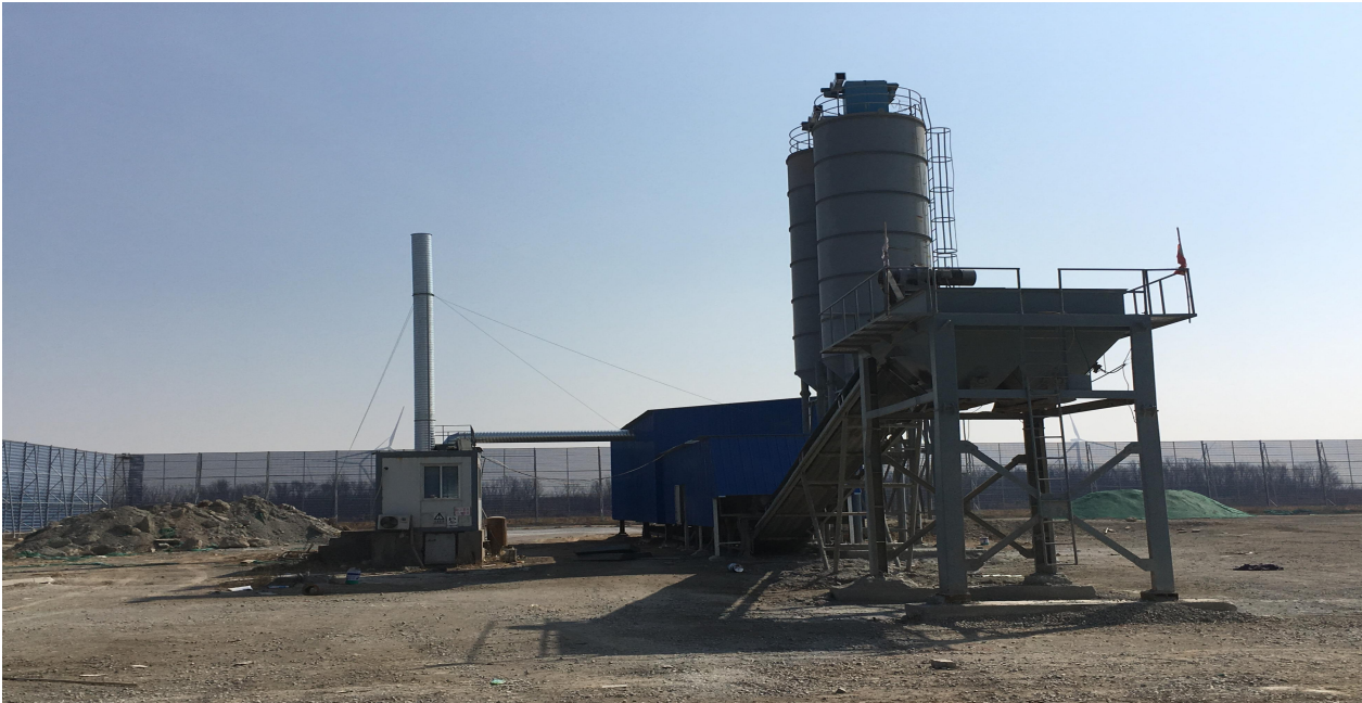
滨州交通工程公司年产 6 万吨水泥稳定土项目现场生产设备
